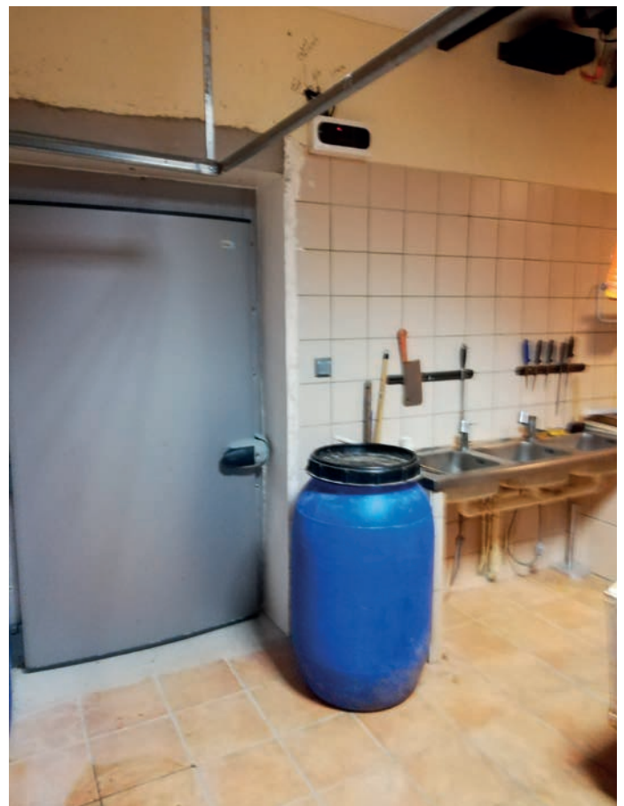
La chambre froide de la maison de la chasse
